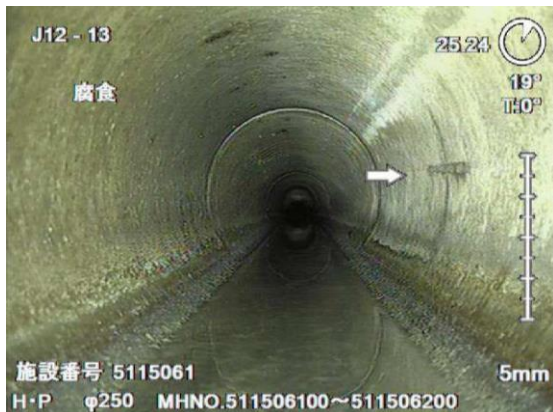
図 3-1. 腐食 A 判定変更箇所（全体）
