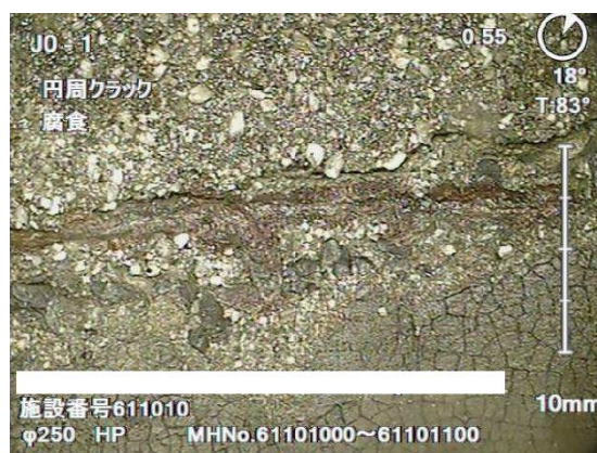
図 4-2. 腐食 A 判定箇所（詳細）
