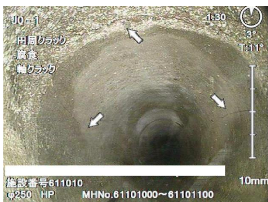
図 4-1. 腐食 A 判定箇所（全体）
