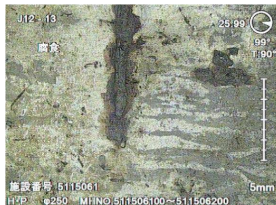
図 3-2. 腐食 A 判定変更箇所（詳細）
