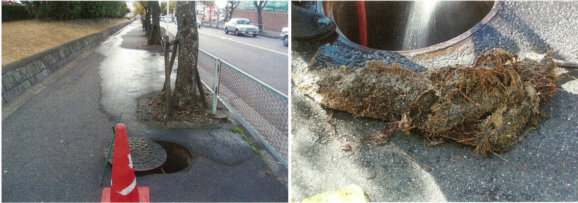
図 3. 樹木根侵入によるマンホール溢水の一例
