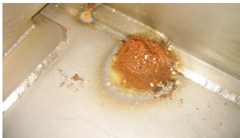
図－7 ステンレスタンク内腐食状況
