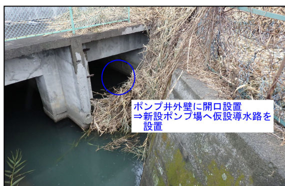
図 - 7 ポンプ井開口箇所（北側側壁）
