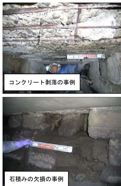
写真 1 雨水幹線に発生する異状の事例
