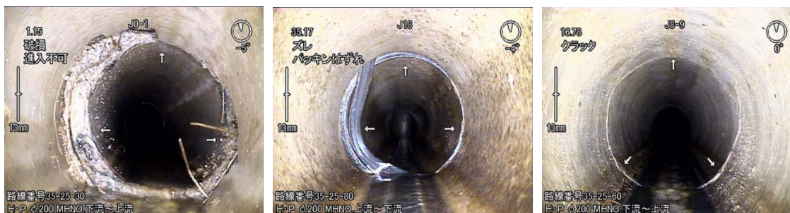
写真2 コンクリート管の被災状況（左：破損、中：継手ずれ、右：亀裂）
