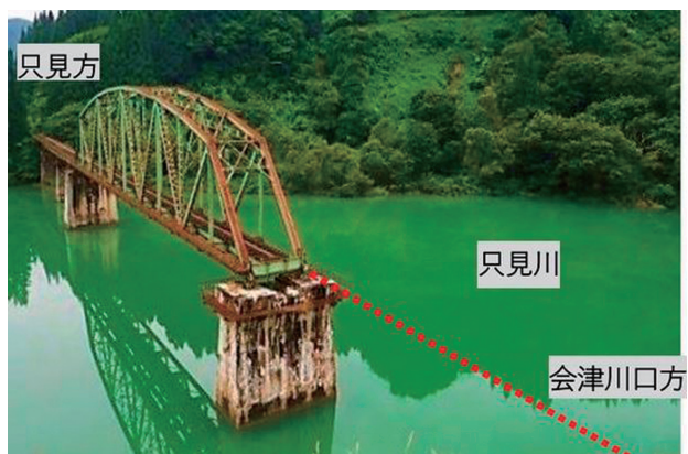
写真－2 流出した只見川第5橋梁（画像：JR東日本）
