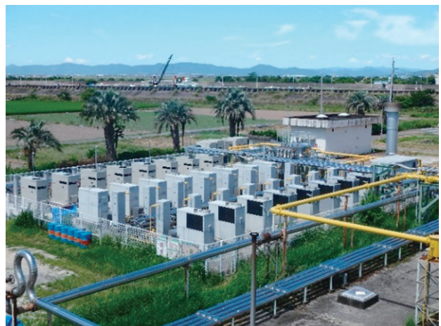
写真－3 消化ガス発電設備
