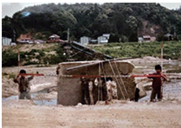
写真－1 災害の状況（橋台が転倒）
