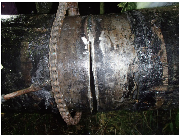
写真-3 溶接部破断状況
