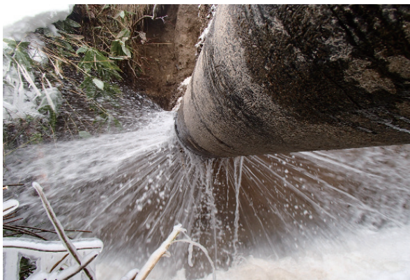
写真-2 平成25年導水管漏水状況
