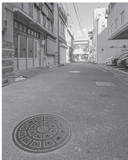
写真-3 昭和初期から現役のマンホール
