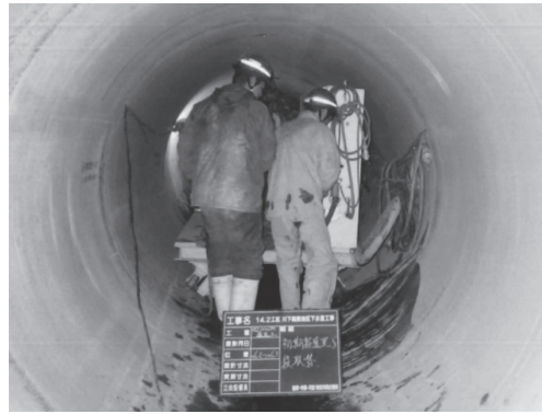
図－7 大口径雨水管
