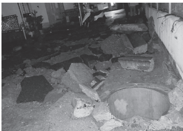
写真－1 マンホール蓋の損傷
