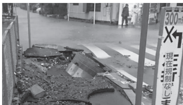
写真－1 大雨による管路施設の被害状況(マンホール破損)
