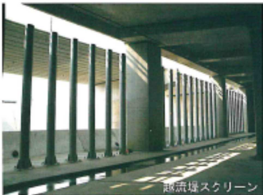
越流堤スクリーン
