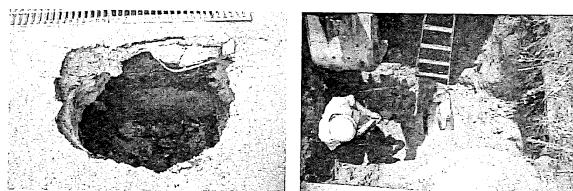
写真－1 道路陥没と修繕の様子
